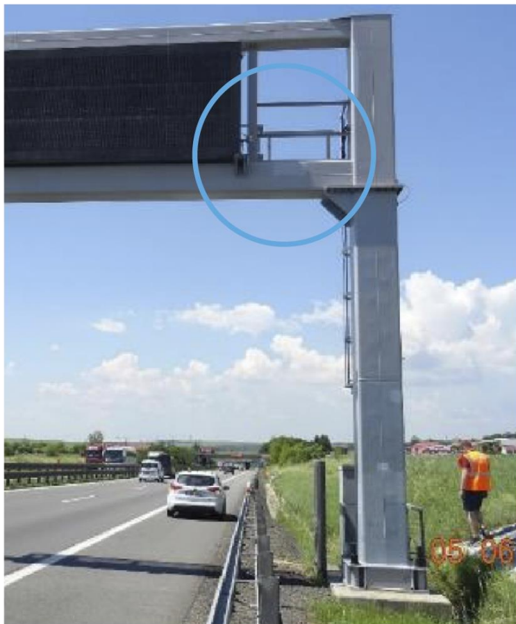
C-ITS RSU instalovaná na informačním portále
