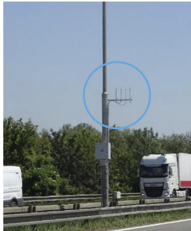
C-ITS RSU instalovaná na sloupu veřejného osvětlení
